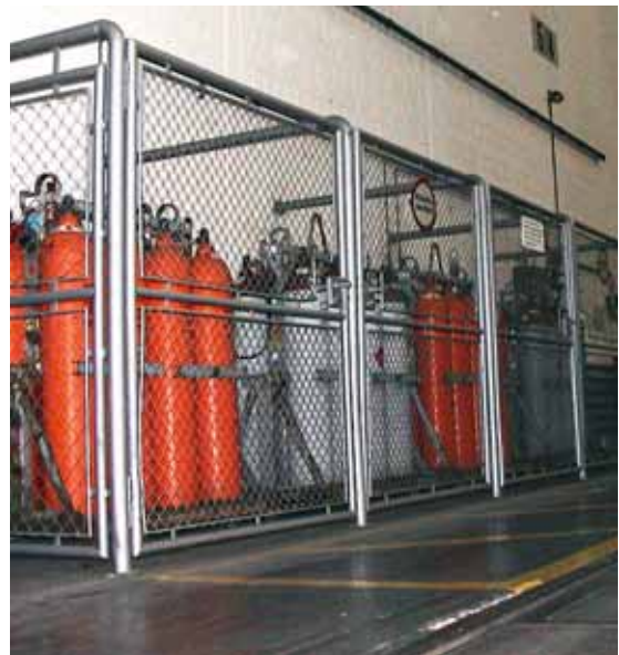
Bild 21: Angeschlossene Gasflaschen in einer Werkhalle
