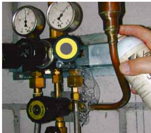
Bild 26: Prüfung der Anlage auf Dichtheit
