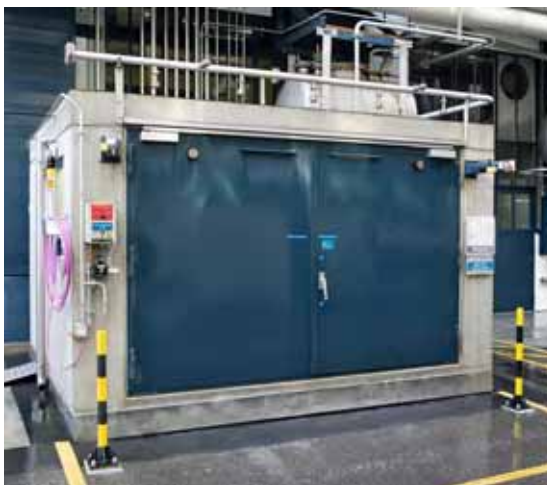
Bild 6: Containment für Gase mit grossem Gefährdungspotenzial
