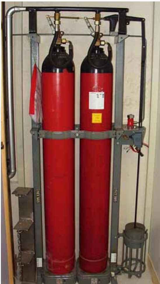
Bild 7: Stationäre CO 2 -Löschanlage
