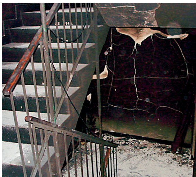
Cage d'escalier envahie de fumée.
