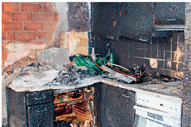
Conséquences d'un incendie de plaques de cuisson.
