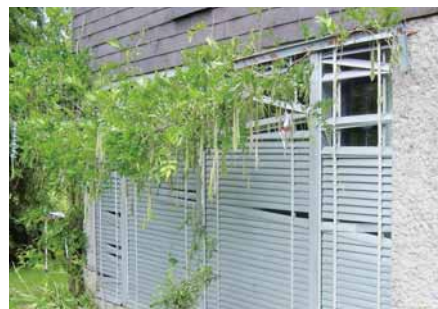
En l'espace de 30 minutes, le front de grêle a endommagé 17 500 immeubles.
