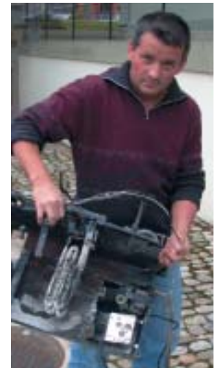
Le concierge Felix Minder avec le corps du délit, le corps de chauffe défectueux.
