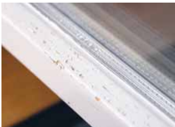
Les grêlons ont endommagé le cadre en bois de la fenêtre.
