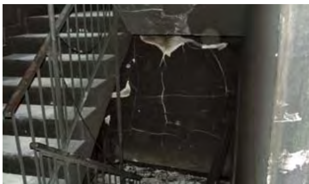
En l'absence d'un sas, les flammes et la fumée ont dévasté la cage d'escalier et l'ont rendu impraticable.
