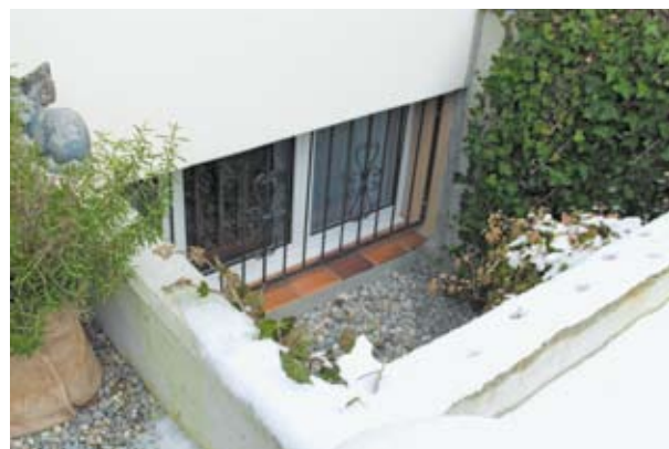
L'ancien rebord qui menait à la fenêtre de la cave a été aplani au niveau du rez-de-chaussée et doté d'un petit mur de protection.
