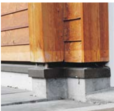
Zeugen des Hochwassers: Verfärbungen am Holz.
