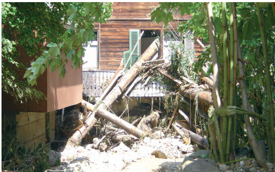
In Eriswil wurden zahlreiche Erdgeschosse und Keller durch Wassereintrüche und Schwemmholz verwüstet.
