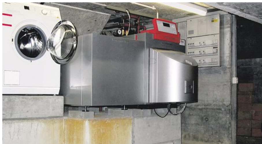
Geht mit einer Energiesanierung einher: erhöhte Heizung und höher gelegtes Elektrotableau zum Schutz vor Wasser.
