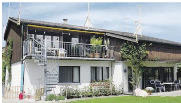
Vor dem Umbau liess das heruntergezogene Dach auf der Südseite wenig Tageslicht ins Innere der Wohnung.
