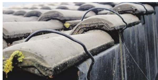
Wirksame Massnahme: Klemme an Dachziegeln gegen Sturmwinde.
